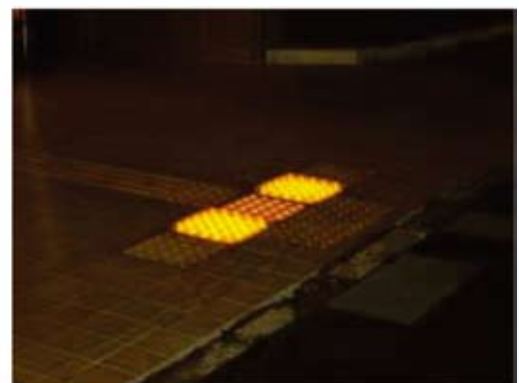
LED内蔵歩行誘導ブロックの設置例
